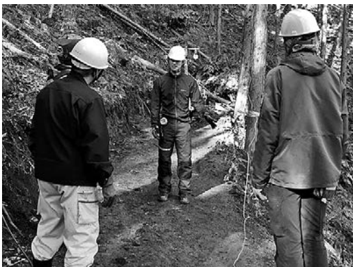
新しく作った作業道で、軽架線を使った間伐材搬出研修
