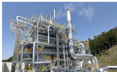
2015年4月に稼動したバイオマス発電所
