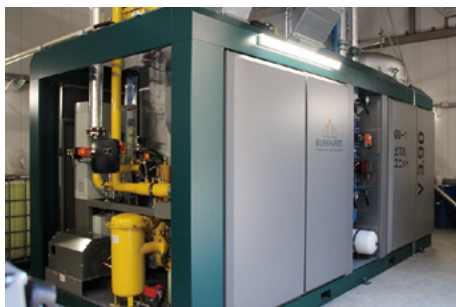
木材から電気と熱を生み出し、エネルギー効率を最大化
